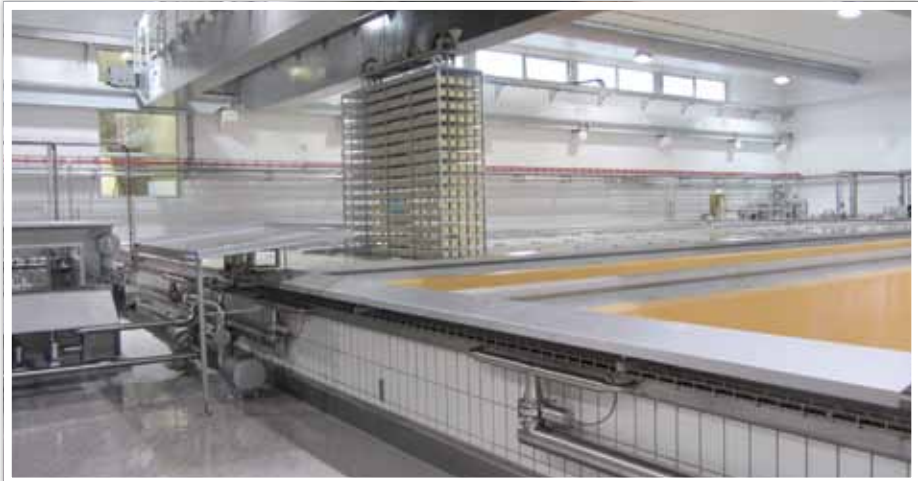
Das Salzbad ist aus sieben Becken aufgebaut und wird über einen sanft anfahren- den Portalkran mit Horden bestückt (Foto: Ramm)
